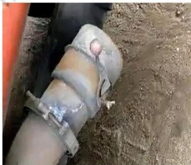
图1 受高温影响老化失效的机动车排气火花熄灭器
